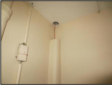
Photo N° 1144 AMIANTE CIMENT -- PALIERS RDC à +4 Gaines & coffres verticaux Fourreau
